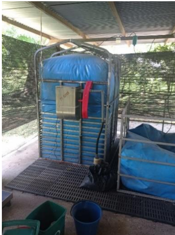
EL BIODIGESTOR MUNICIPAL ASISTIDO POR LA CAR
